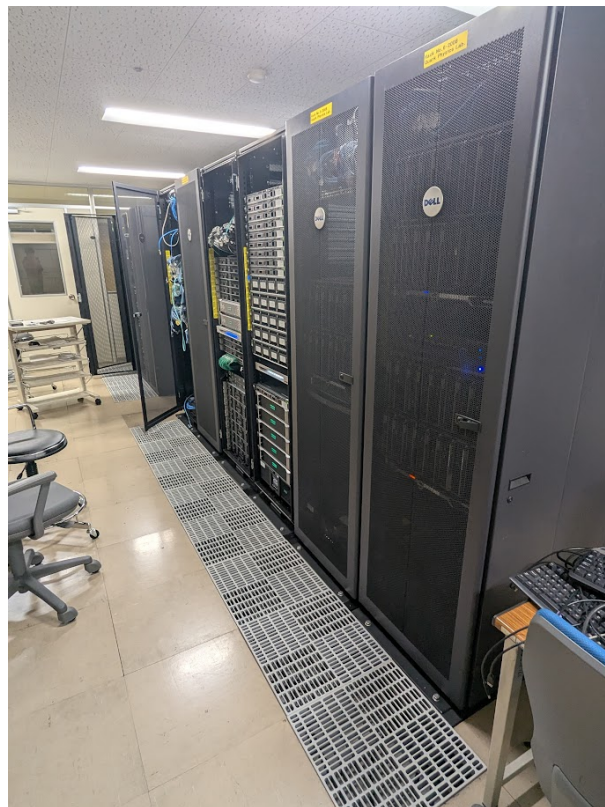
図 2.1: サーバルーム
